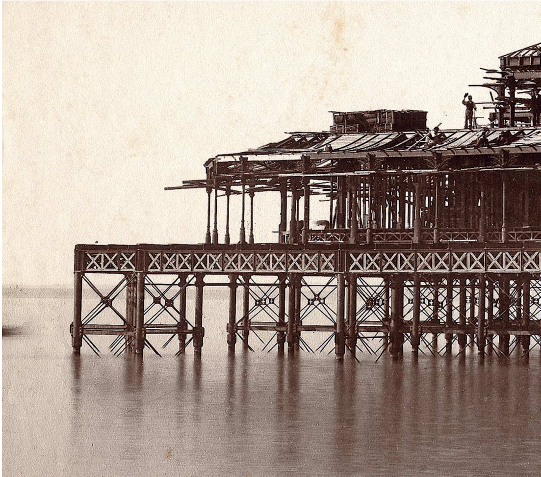
▲ FIG. 8. Photographie de la première construction du bâtiment de la « Jetée-Promenade » à Nice. Cliché J. Gilletta, Nice, Bibliothèque de Cassole.
