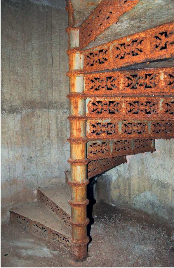
FIG. 57. Escalier métallique appartenant au casino « Jetée-Promenade » de Nice retrouvé en réemploi dans un réseau souterrain creusé par l'armée allemande au pied de la colline du château. Cliché A. Grandieux.
