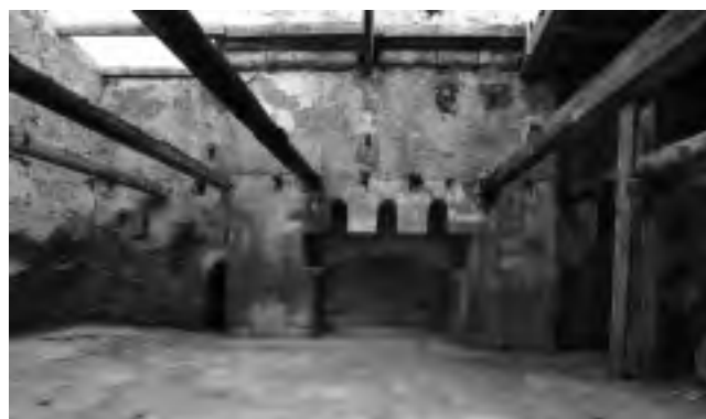
Fig. 116 – PORT-DE-BOUC, mas de l'Hôpital. Les restes du pressoir à vis (cliché H. Marino / SAVM).
