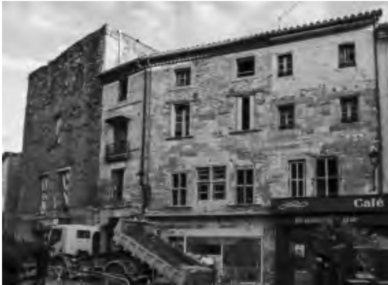
Fig. 191 – L'ISLE-SUR-LA-SORGUE, Tour d'Argent : bâtiment résidentiel. Façade principale après décroûtage (cliché Fr. Guyonnet / DPI).
