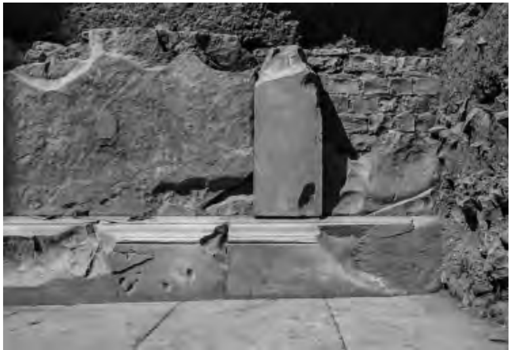
Fig. 212 – VAISON-LA-ROMAINE. Avenue Jules Ferry. Vue de détail du parement du mur podium (cliché J.-M. Mignon / SADV).
