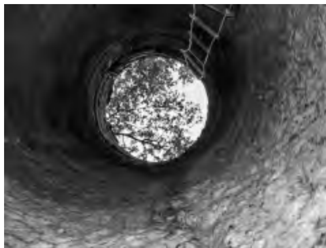
Fig. 133 – Aqueduc romain de Traconnade. Regard circulaire (diam. : 1 m ; prof. 5,20 m) construit en petit appareil sur environ 1,50 m puis taillé dans le rocher (cliché M. Fuhry).
