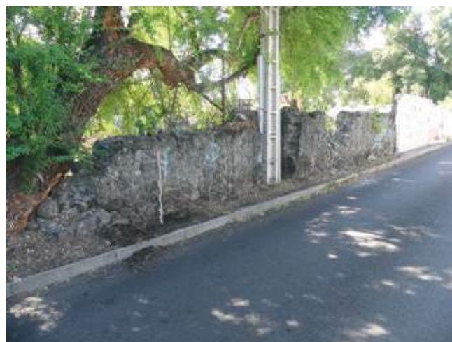
[Fig. 1]: Barreau en cours d'effondrement côté rue des Salins (photo N. Biwer / Inrap)
