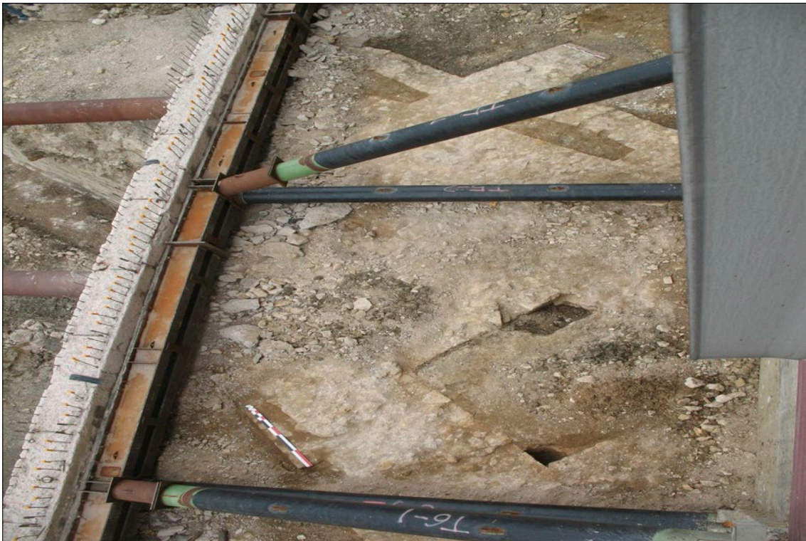
NANCY, ZAC Nancy Grand Cœur, phase 1 Vue en plan des deux états de construction relevés sur la face sud. Outre la différence d'axe d'orientation adopté, ces deux états se distinguent également par le biais de la configuration des contreforts (cliché : Inrap)
