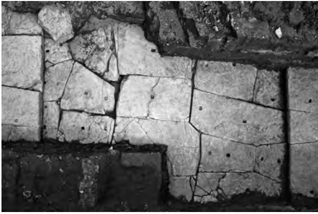
Fig. 96 – ARLES Avenue de Camargue. Vue zénithale de la chaussée romaine encadrée des deux trottoirs (cliché Ph. Mellinand / Inrap).
