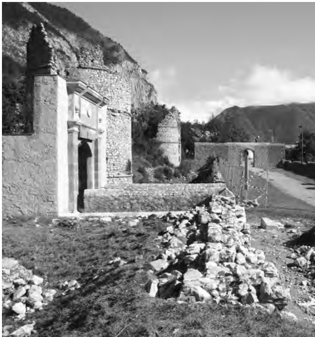
Fig. 26 – LE GLAIZIL, château de Lesdiguières. Vue du sud : dégagement du mur parapet au premier plan avec le double parement à l'ouest. À l'arrière-plan, la porte centrale, la fosse est, le château ruiné (cliché L. Pinet / MMD-CG05).
