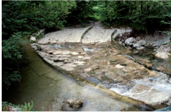
Saint-Gervais-les-Bains, fonderie de canons, bassin de captage.
