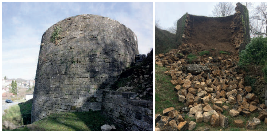
Tour de la Chapelle avant et après l'effondrement du printemps 2018
