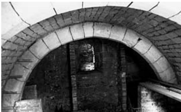
Brionne, rue Lemarrois : Vue de l'intérieur de la cave depuis le Nord (B. Guillot, INRAP)
