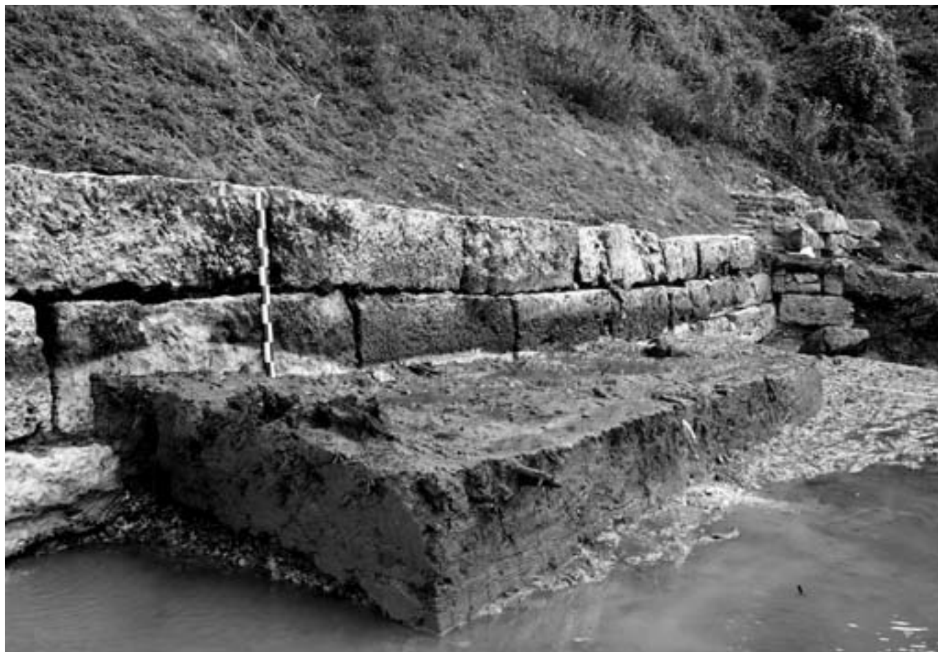
Aizier, Berges de la Seine : Vue en coupe de l'US 1002 au contact de l'aménagement MR1005 (secteur C – sondage 1), prise du nord-est (J. Mouchard)
