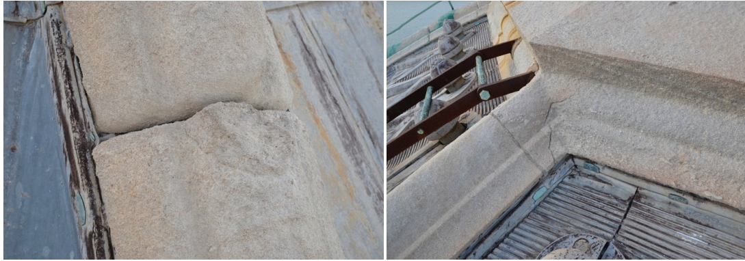
Détails des dégradations des nervures pierre. Traces d'oxydation, érosion, déjoints, fissuration
