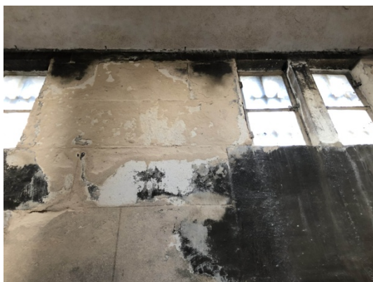
Vue intérieure de la galerie avec traces d'infiltrations et de sels sur le côté ouest.
