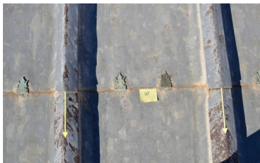
Glissement des couvre-joints des tables en plomb. Fissuration des tables en plomb.
