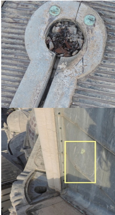
Vue générale et détails des dégradations du plomb : Manque des boutons, oxydation, défaut d'étanchéité des attaches et crochets, déchirures, tables manquantes.
