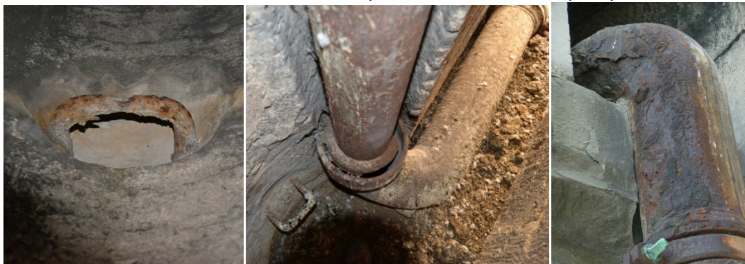
Echelon corrodé. Coude non étanche. Coude de sortie très corrodé.
