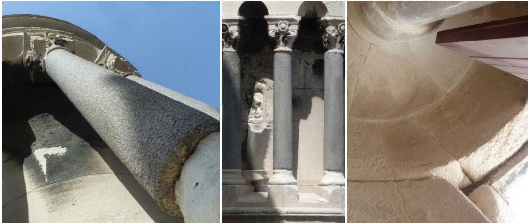
Détails sur les colonnes et les parements. Vue intérieure : sels et érosion du chaînage.
