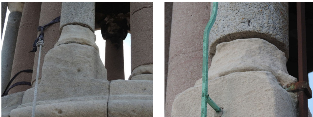
Détail sur les bases de colonnes fortement érodées et désagrégées
