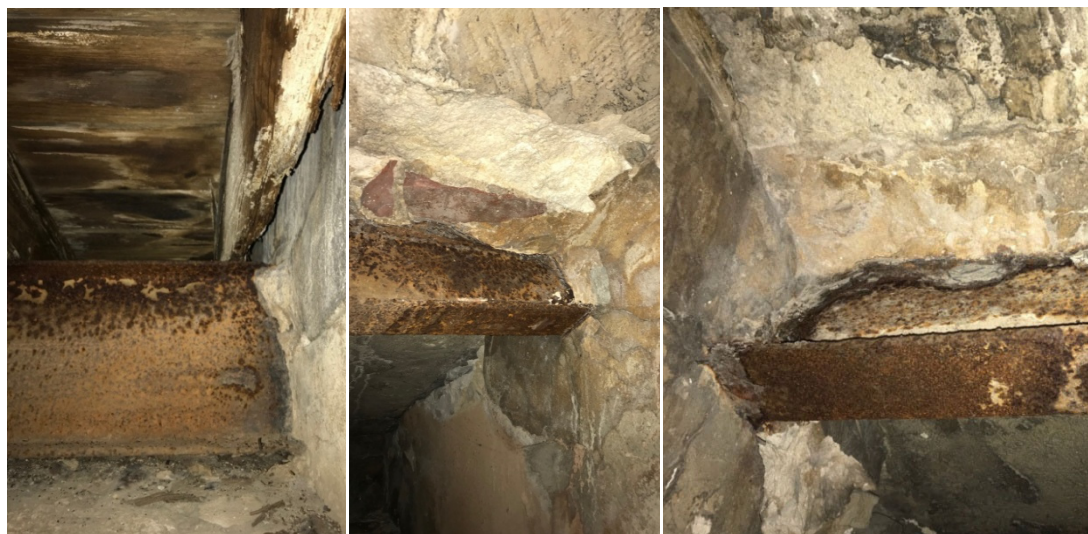
Détails de la corrosion des pannes et des sommiers dégradés
