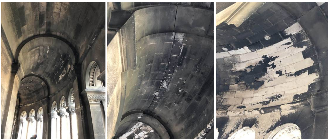
Vue générale de la galerie avec les fissurations et les infiltrations d'eau
