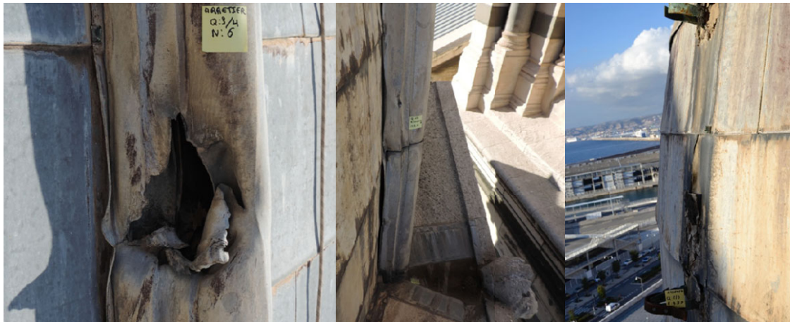
Détails des dégradations des arêtiers. Impacts perforants, déboitements ou manques
