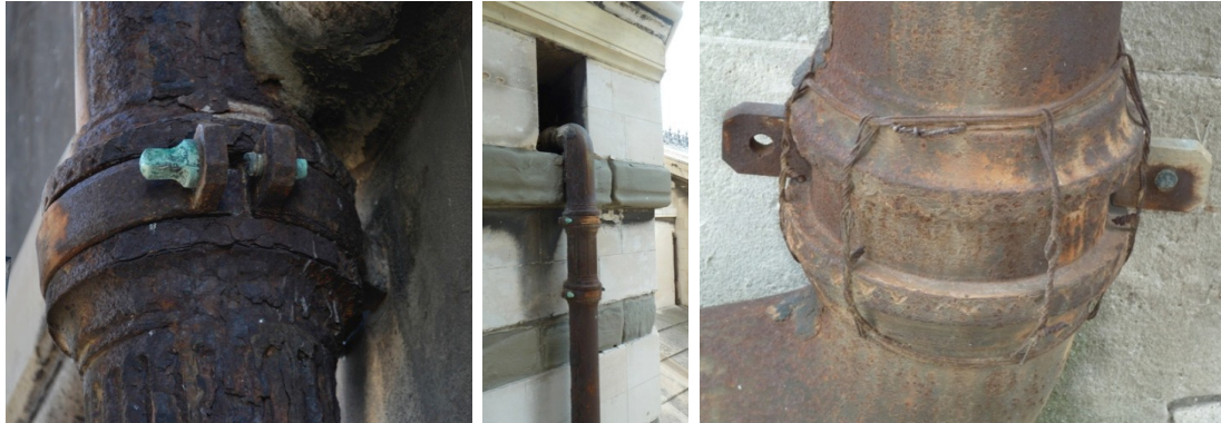
Canalisations extérieures en pied de chute très corrodées
