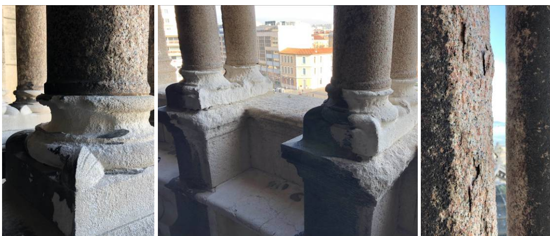
Bases colonnettes fortement érodées et déplaquage des futs en granite rose
