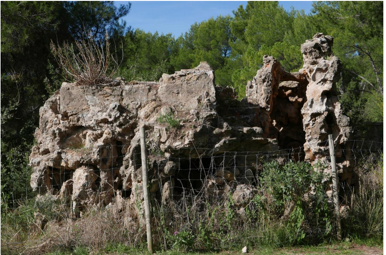
Fig. 14. Rocaïlle à l'abandon. Rocaïlle de L'Ensoleillée, Aix-en-Provence (Bouches-du-Rhône) © F. Cranga 2019
