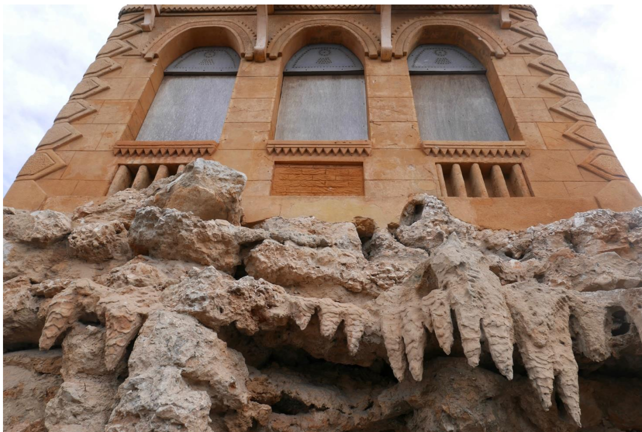
Fig. 17. La grotte sous le pavillon, XIXe. L'Agachon de la Soude , Marseille (Bouches-du-Rhône) © F. Cranga, 2018
