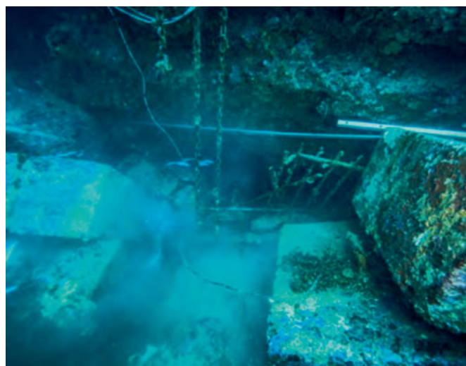
Fig. 22. Le porche de l'entrée est découvert. Complètement oxydé, l'ancien ferrailage est encore visible.
